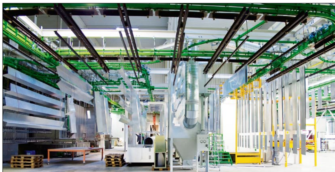
In der neuen Lackieranlage von LOV können Großteile bis 3 m Breite und Höhe beschichtet werden. Das Bild zeigt die Einlaufseite der beiden Automatik-Pulverkabinen.
