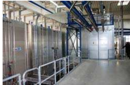
Das teilautomatisierte Pulverbeschichtungssystem verfügt über eine flexible Transporteinheit mit Hub- und Senkstationen sowie eine abwasserfreie 2-Kammer-Vorbehandlungsanlage.
