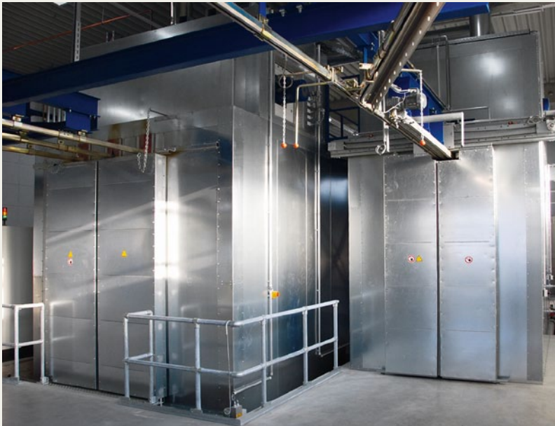
▲ Um einen möglichst wirtschaftlichen Betrieb zu gewährleisten, wurde die Anlage nicht nur mit einer Wärmerückgewinnung, sondern auch mit energieeffizienten Antrieben ausgestattet
