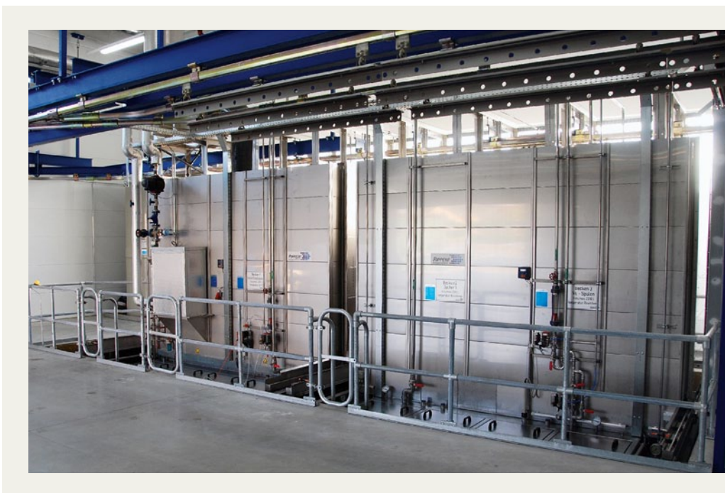
◀ Das abwasserfreie 2-Kammer-Vorbehandlungssystem ist mit einer Schwadenabluftanlage ausgestattet. Die Frischwasseraufbereitung erfolgt durch Umkehrosmose.
