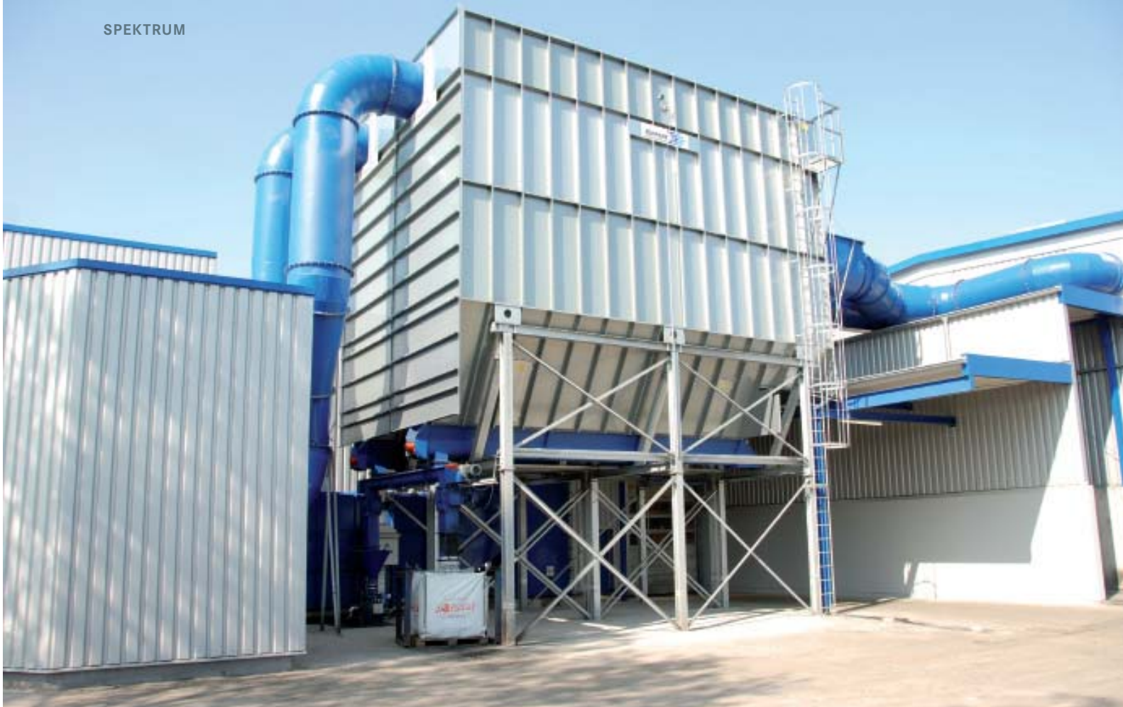
Niederdruckspülluft- anlage in der Jürgens Gießerei in Emsdetten.
