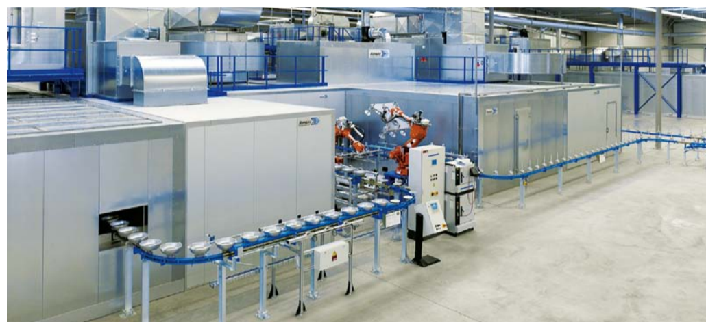
Lackieranlagen und ihre Peripherie bieten viele Ansatzmöglichkeiten für den nutzbringenden Einsatz automatisierter Lösungen.
